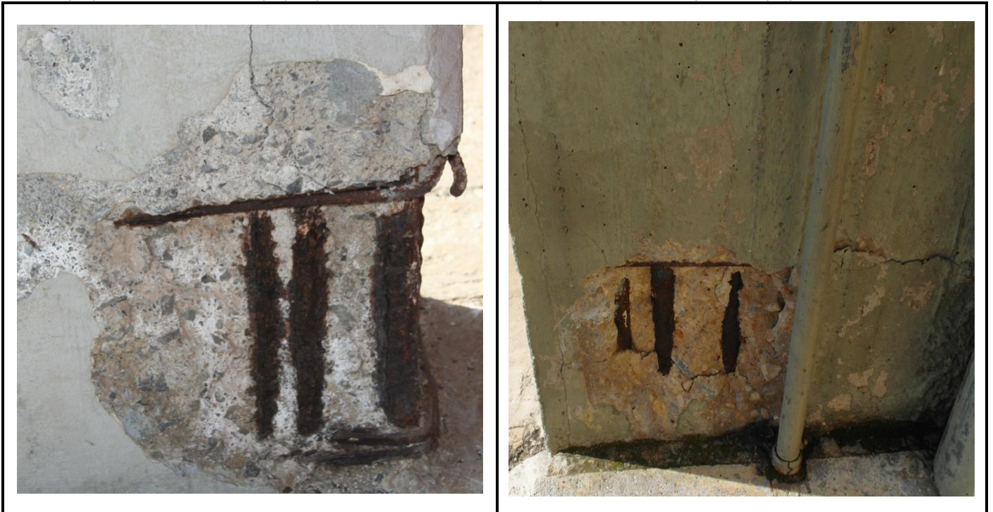
Εικόνα 4. Έντονη διάβρωση, απομείωση διατομής μεταξύ 20% και 40% σε δύο γειτονικούς στύλους. Βαθμονόμηση 75%.
