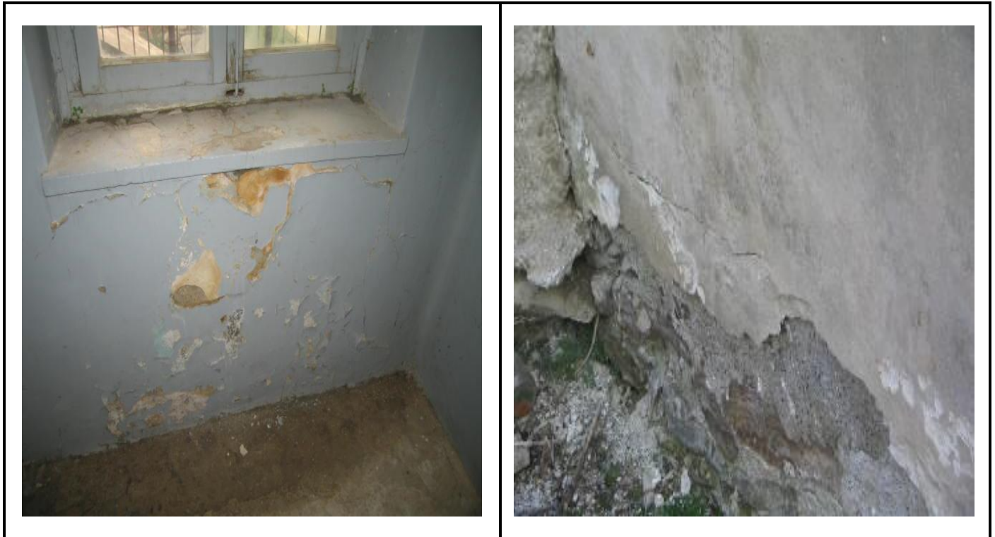
Εικόνα 7. Εκτεταμένη υγρασία, ελλιπής συντήρηση, αποκολλήσεις επιχρισμάτων τοπικού χαρακτήρα σε κατασκευή από φέρουσα τοιχοποιία. Βαθμονόμηση 25%.
